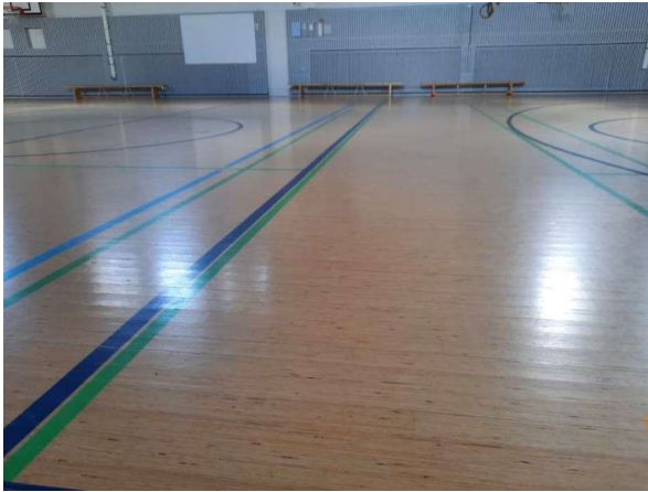
105. Liikuntasalin lattiassa havaittavissa kulumaa.
