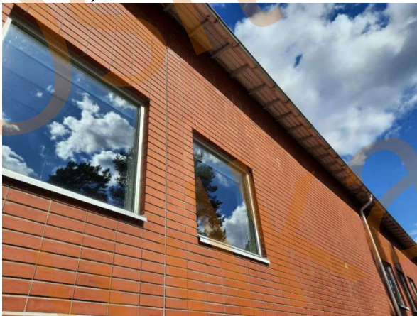
42. D-osalla elementit hieman käyristyneet.
