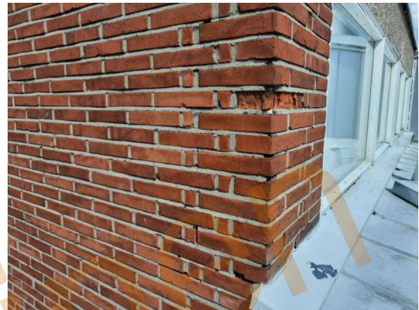
53. A ja B osan tiiliverhouksissa vauriota.
