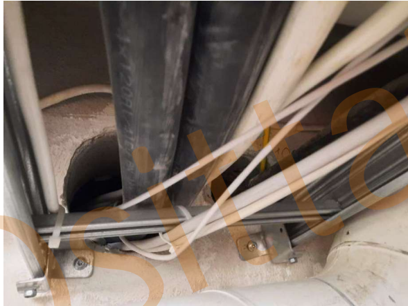
198. Kaapeliläpiviennit osin epätiivitä.
