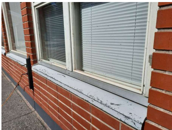
56. D-osan puuikkunat kuluneita.
