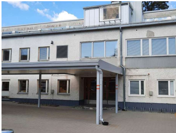
52. B-osalla rappauksissa vaurioita.
