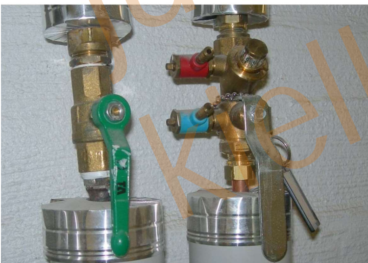
Kuva 5: Lämpimän käyttöveden palloventtiilit.
