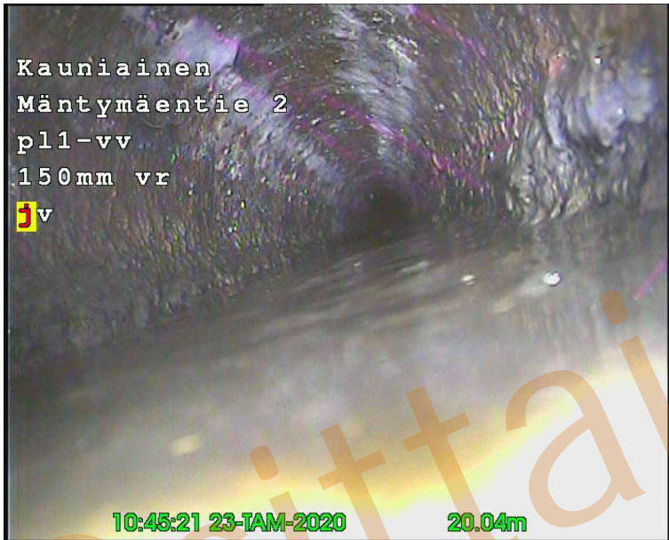
Kuva 10: Kohtalaista painumaa pohjaviemäriputkessa.
