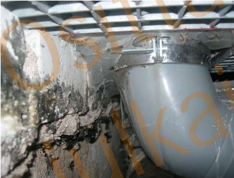
Kuva 6: Vuotoa pystyviemäriin pantaliitoksesta.
