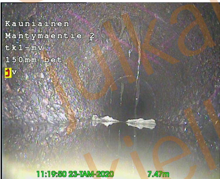
Kuva 12: Kiviaines näkyvissä betoniputken sisäpinnalla.
