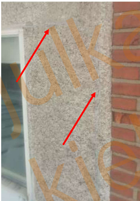
Kuva 34. Rappauksen halkeilua on korjailtu elastisella saumamassalla.
