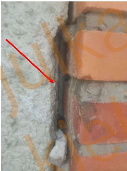
Kuva 38. Tiilimuurauksen ja rappauksen rajapinnassa on avoimia saumoja rakenteisiin sekä rajapinnoilta on irronnut rappauksen palasia.
