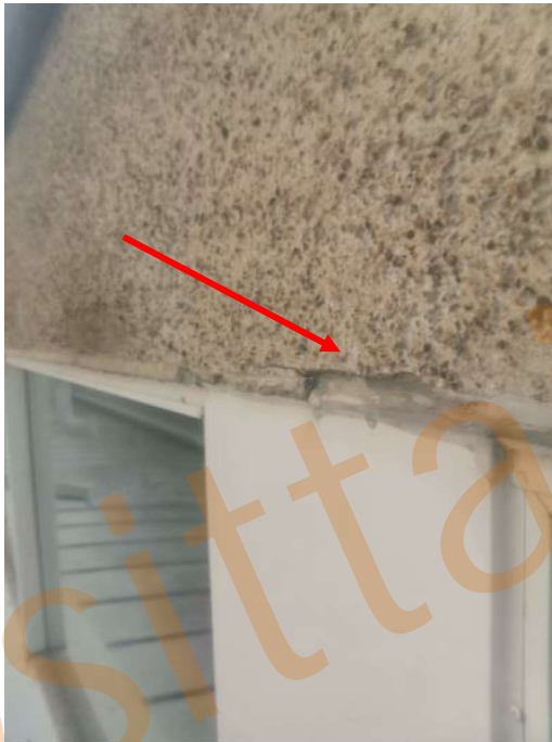
Kuva 35. Rappauksen vaurioita on korjailtu silikonilla.
