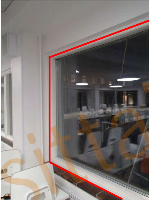
Kuva 111. Ruokalan ikkunoiden rajapinnoilta havaittiin vahva viite vuodosta.
