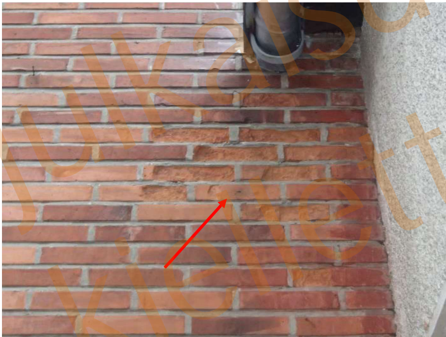
Kuva 48. Tiilimuurauksesta on irronnut rapautumisen seurauksena levymäisiä palasia.
