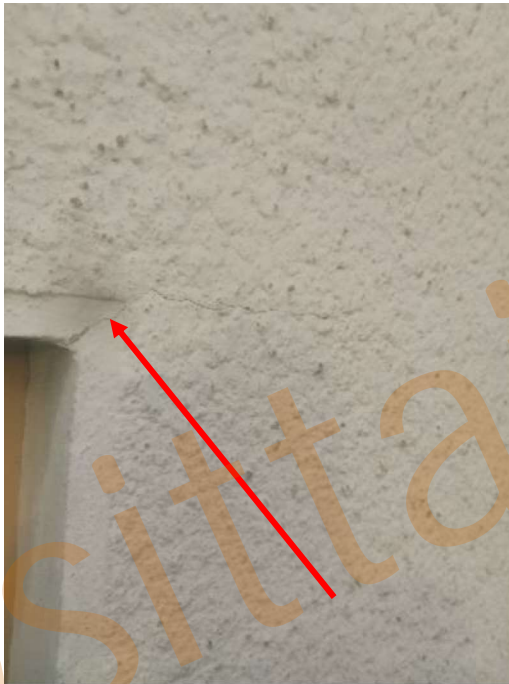
Kuva 21. Rappauksen halkeilua ikkuna-aukkojen kulmissa.
