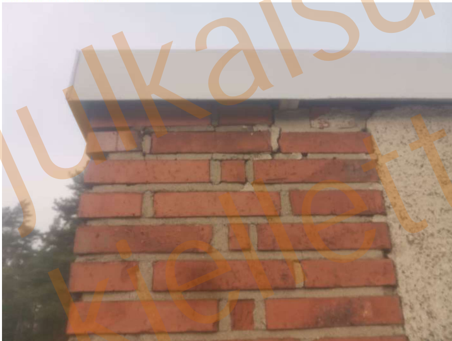
Kuva 50. Tiilimuurauksen yläosissa on laastisaumojen rapautumista ja tiilet ovat irronneet muurauksestaan.
