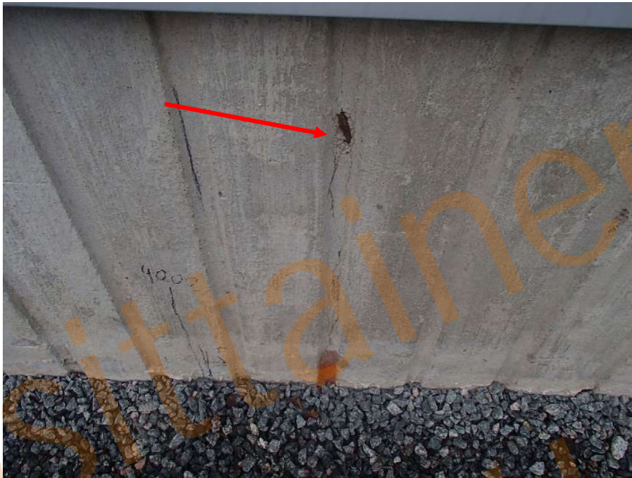
Kuva 41. Sokkelissa havaittiin halkeilua ja raudoiteteräkset ovat paikoin lähellä ulkopintaa.
