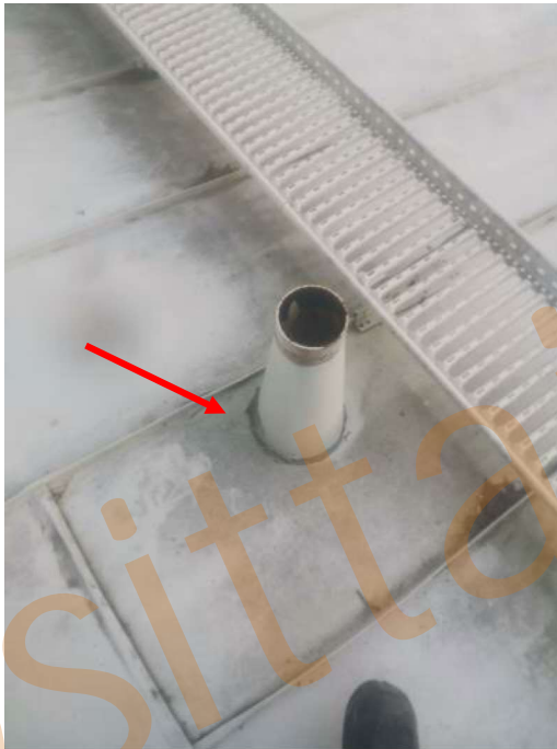
Kuva 79. Lämpivientien tiivistykset ovat paikoin ikääntyneet.
