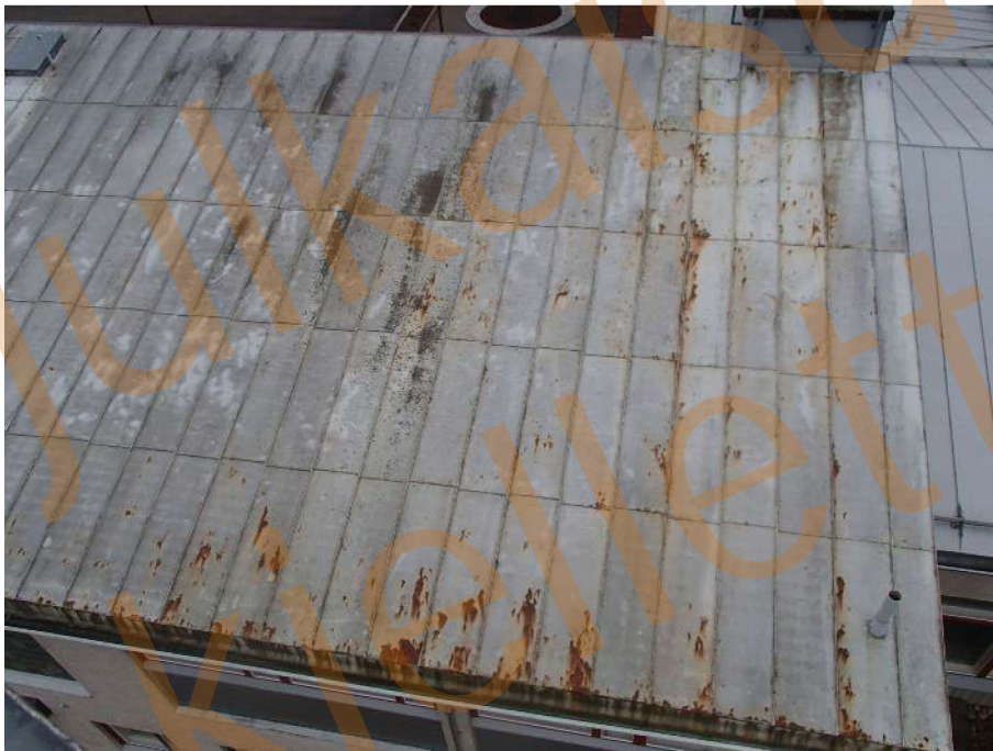
Kuva 78. Vanhan koulurakennuksen vesikatteessa havaittiin paikoin voimakasta korroosiota ja maalipintojen ikääntymistä.
