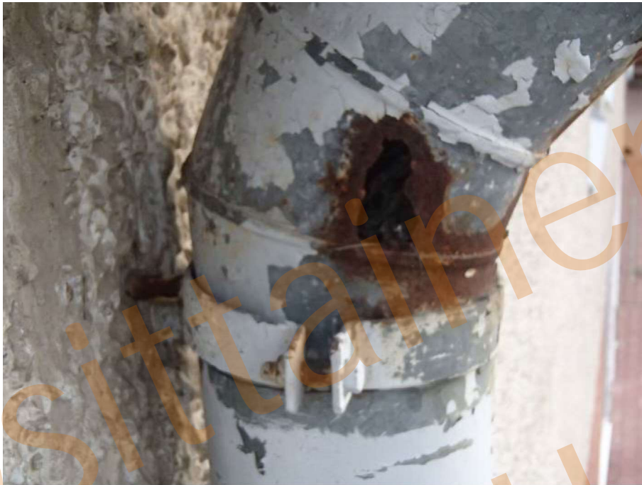
Kuva 81. Syöksytorvissa havaittiin reikiä.
