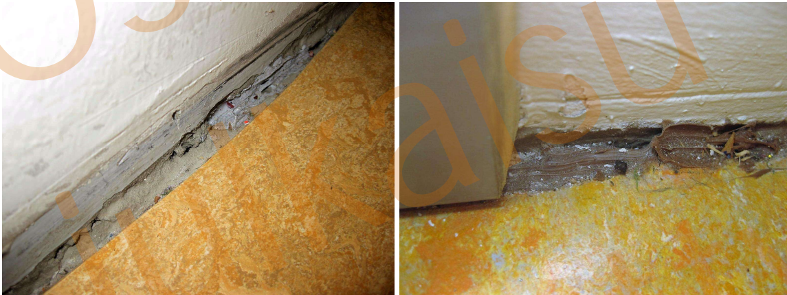
Seinän ja lattian välissä selkeitä ilmavuotoreittejä
